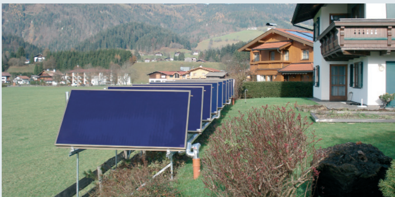
Modulové kolektory FM-S upevněné na konstrukci na volnou plochu
